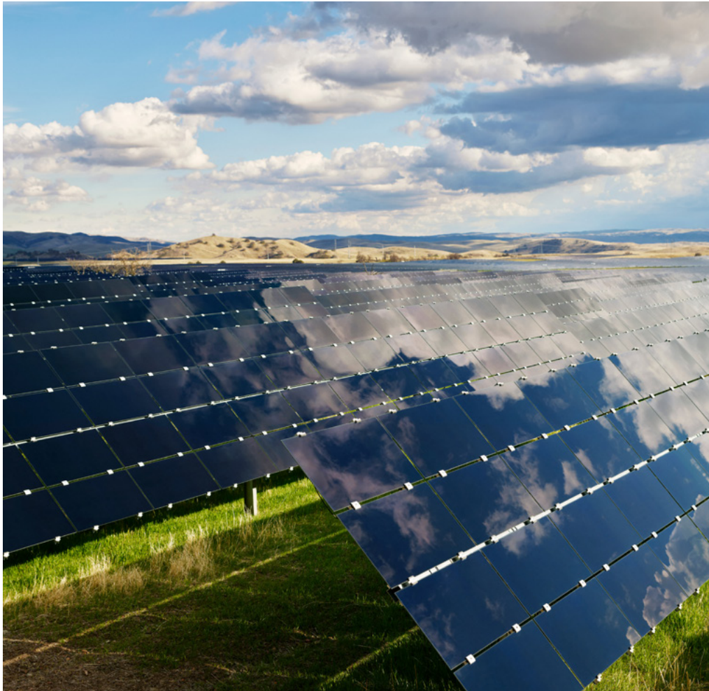
Apple hat in das California Flats Energiespeicherprojekt investiert, das erzeugten sauberen Strom aus intermittierenden erneuerbaren Energiequellen speichert, unter anderem aus dem benachbarten 130-Megawatt-Solarprojekt California Flats (Abbildung).
