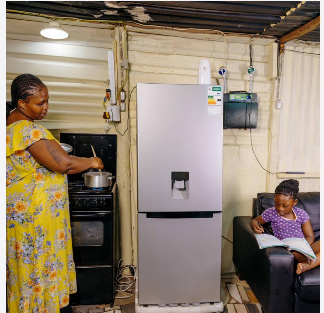
Durch die Stromversorgung in ihren Häusern im Rahmen eines der Projekte in Südafrika können Kinder jetzt abends ihre Hausaufgaben machen und Familien können im Innenbereich Mahlzeiten zubereiten.
